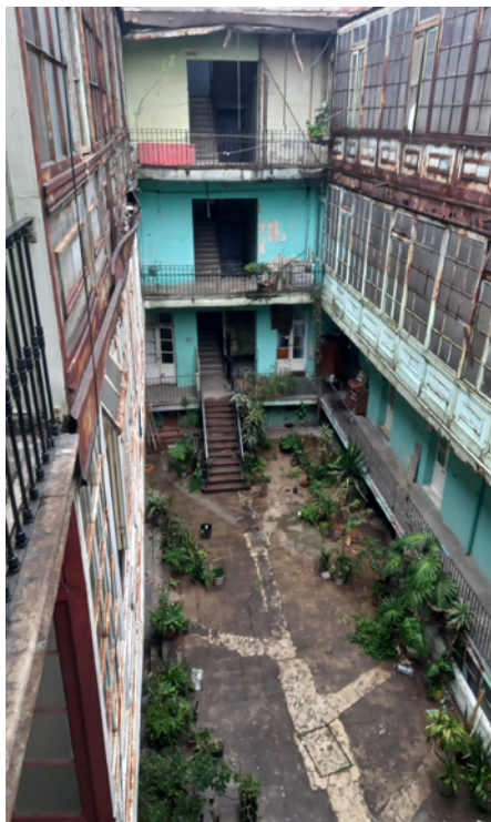
Figura 5. Se puede apreciar el estado de conservación y las nulas acciones de remodelación del edificio ubicado en Turín 41, que destaca por su patio central y sus vitrales en los pasillos. Fuente: Juan Carlos Caballero, 2022.
