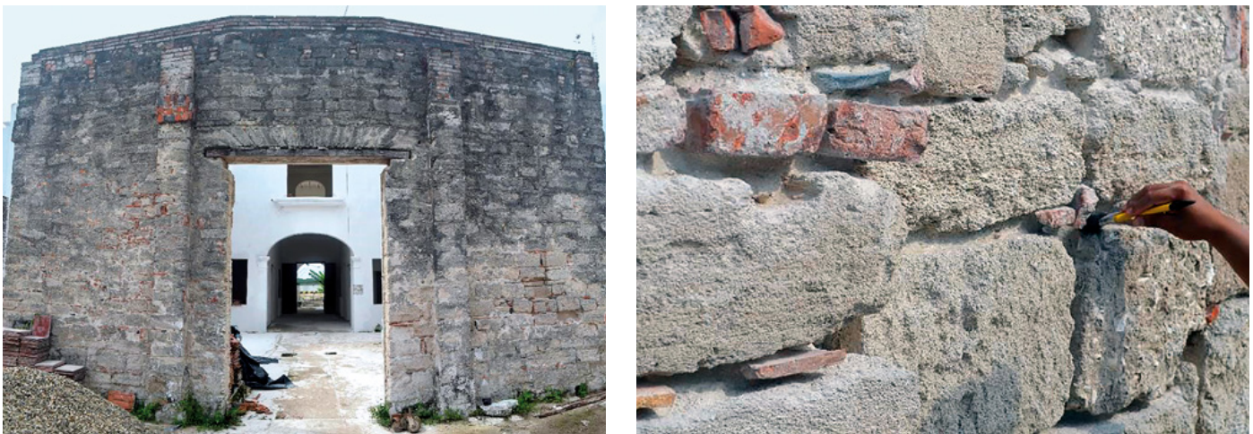
Figura 5. Detalle del sistema constructivo de la Aduana. Izquierda: paramento oriente del patio interior que muestra los bloques de conchuela. Derecha: detalle de los bloques de conchuela y elementos de ladrillo, mosaico y teja empleados en las juntas a manera de cuñas. Fotografías: Geiser Martín Medina.
