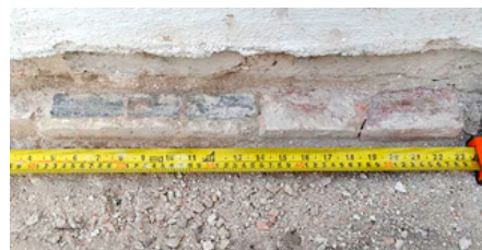
Figura 10. a) Sección de estampado de piso original debajo del piso de concreto retirado. b) Detalle de mosaicos de pasta rojo y negro en la base de una columna del patio de almacenaje. c) Evidencia de piso rojo y negro a nivel de muro donde se observa el nivel de piso original y el nivel de piso actual que fue retirado. Fotografías: Geiser Martín Medina.
