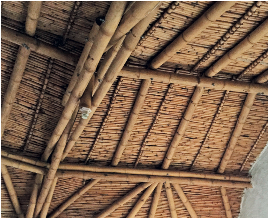
Figura 12. Las estructuras de guadua tienen la cualidad de potenciar la autoconstrucción asistida porque utilizan tecnologías sencillas, con costos de adquisición de materiales y de mano de obra accesibles en comparación con los industrializados. Fotografía: Luis F. Guerrero.
