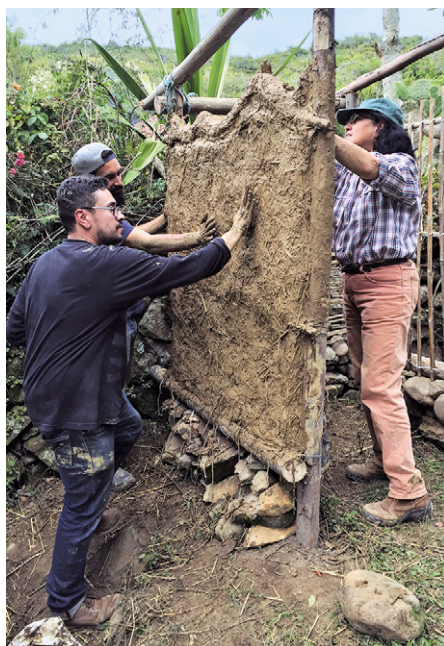
Figura 7. Elaboración de bajareque de tierra sobre paneles de guadua en un taller comunitario de Villa de Leyva, Colombia. Fotografía: Luis F. Guerrero.
