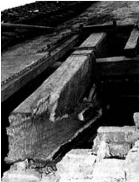
Figura 2.- Madera con el apoyo degradado y pérdida de la funcionalidad de la cadena de apoyo (Jurina, 1989)
