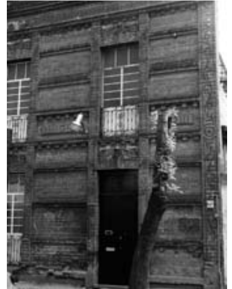
Figura 8.- Casa de tabique aparente, con deterioro relativo. Foto: A. Contreras, 2005.
